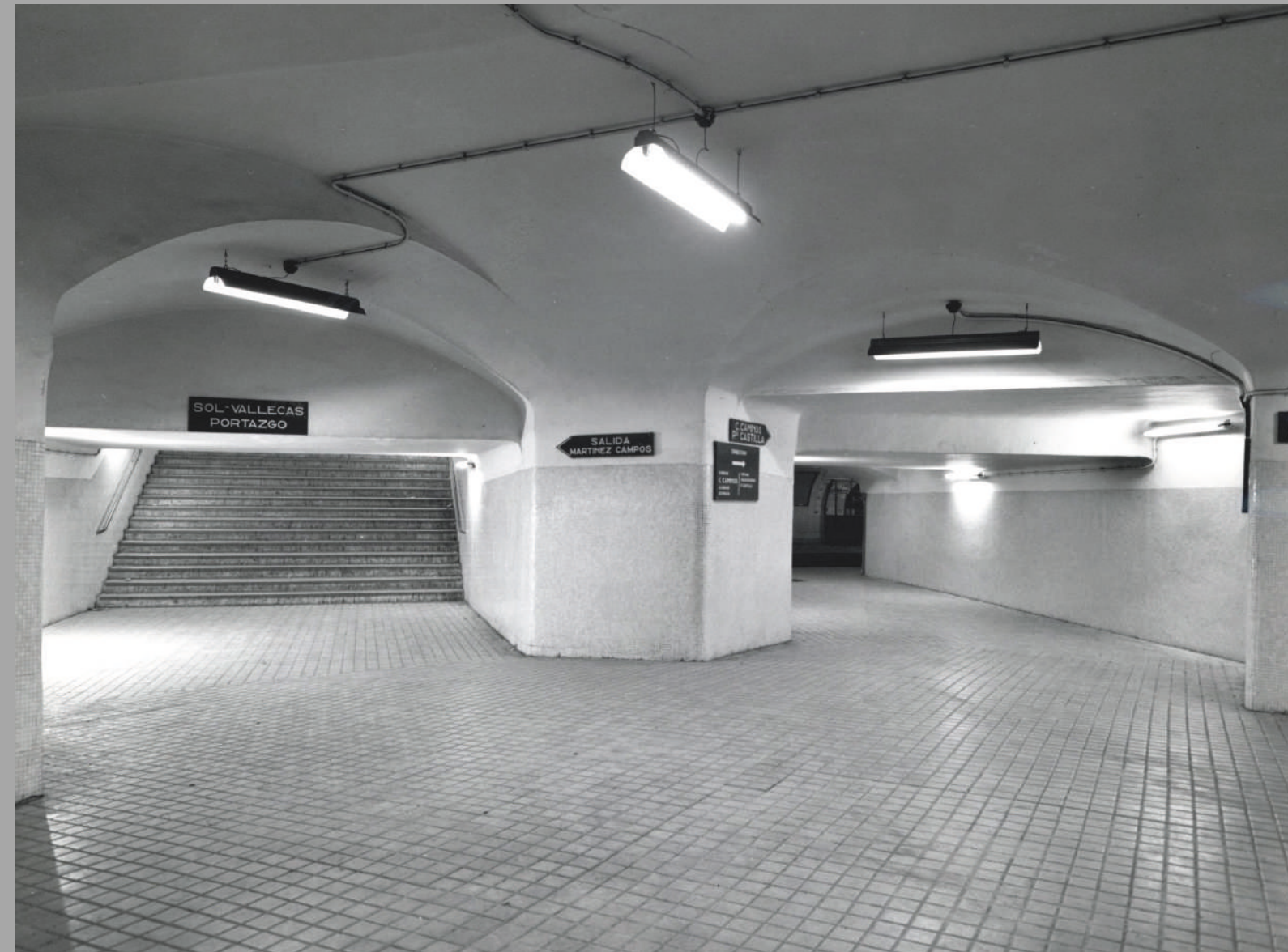
Pasillo de la estación de Iglesia, 1965 [Archivo Histórico de Metro de Madrid]
